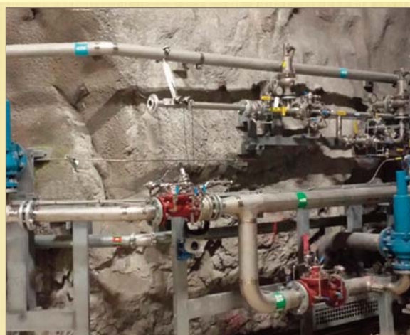
Estación subterránea a gran profundidad de reducción de presión
