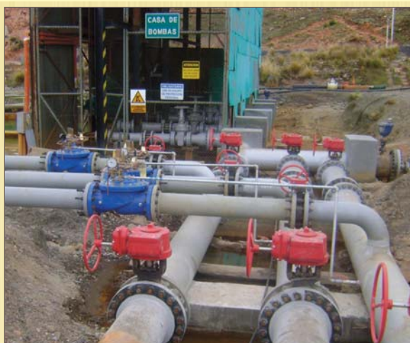
Válvulas de Alivio de Presión y Disipadoras de Golpe de Ariete, y válvulas de aire para estaciones de bombeo
