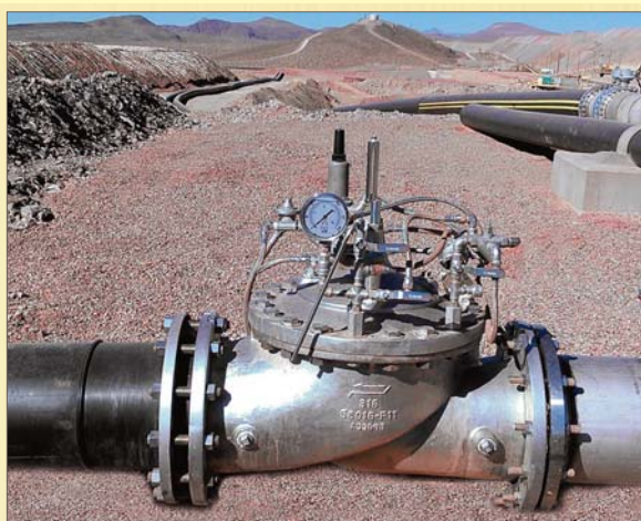
Válvula Reductora de Presión de Acero Inoxidable en campo de lixiviación
