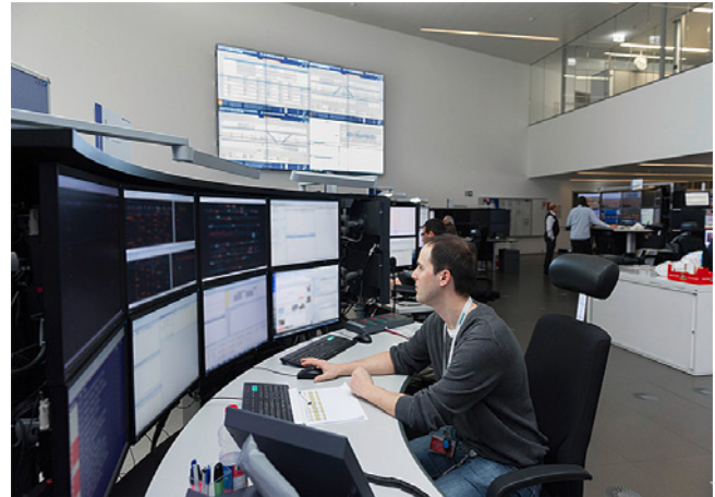
Sala de control con WinCC OA
